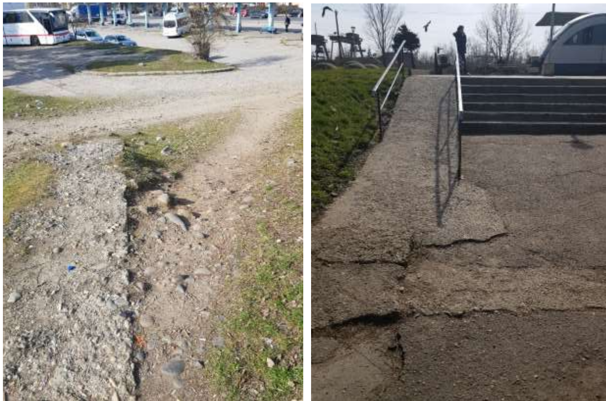
Figură 79 - Imagini reprezentative zona Autogării și Gării - Lipsa rampelor sau prezența rampelor incorect proiectate
